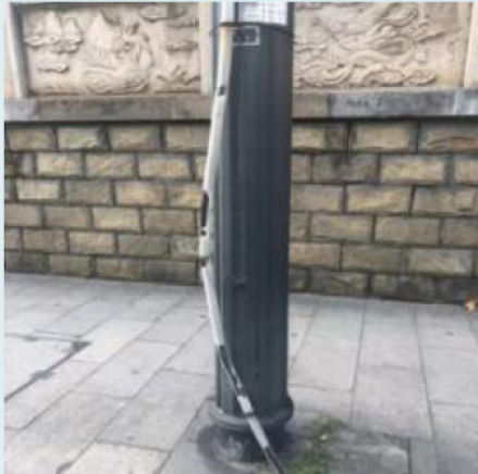
路灯电线外包塑料壳破损
