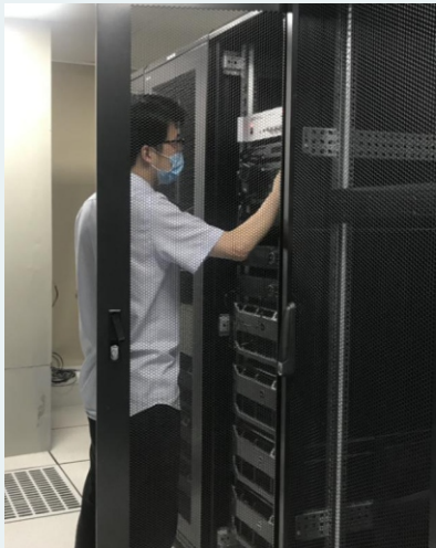
对机房日常运维进行管理
